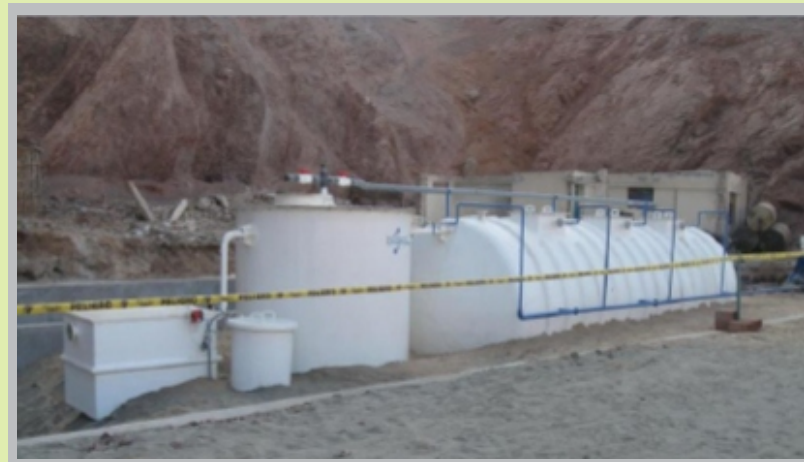
Moderna Planta de tratamiento en base a lodo activado.
