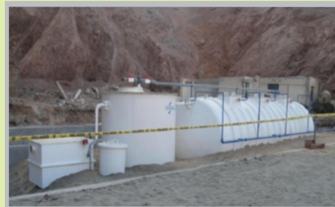
Moderna Planta de tratamiento en base a lodo activado.
